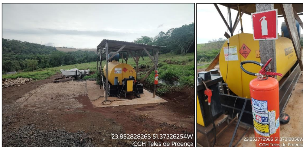
Figura 6 – Tanque de combustível.
