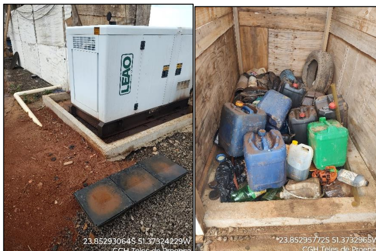
Figura 31 – Área de contenção – Gerador e baia de resíduo.
